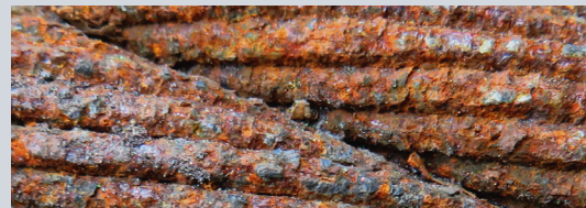
Vergrößerung von äußerer Korrosion
