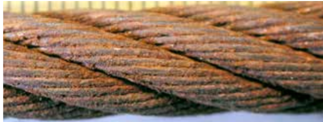
2. Drähte fühlen sich rau an, allgemeine Oxidation der Oberfläche. Einstufung: 20 % der Ablegereife.
