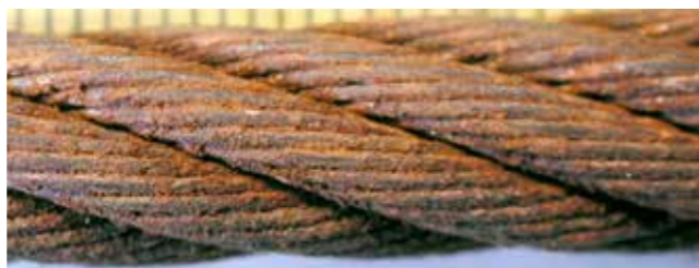
2. Cables ásperos al tacto, oxidación general de la superficie - Clasificación: 20% hacia el descarte
